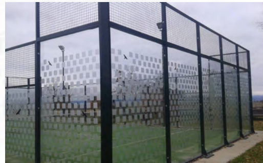
Estado actual de las instalaciones con vinilos en Prádena del Rincón
