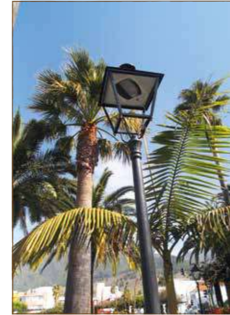
Luminarias innovadoras en la RB La Palma, con un sistema para evitar la contaminación lumínica hacia arriba. Sustitución del alumbrado público exterior tradicional por bombillas con tecnología LED.
