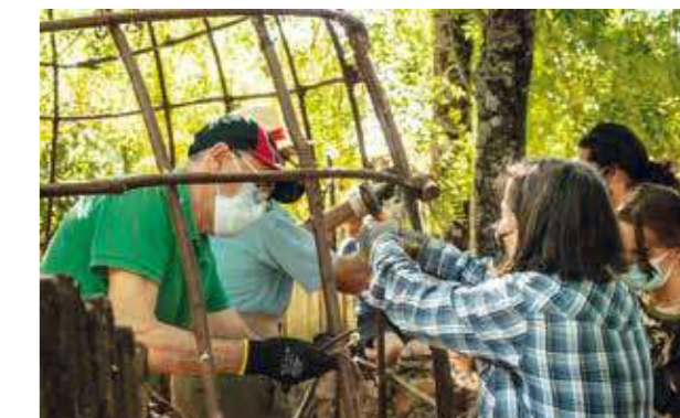
Elaboración de un chozo de pastores en el Jardín Botánico el Robledo, en la Reserva de la Biosfera de Dehesas de Sierra Morena. En cualquier momento de la historia, el trabajo colaborativo ha sido una herramienta eficaz para aportar bienestar a los grupos humanos.
