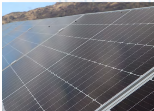
Instalación fotovoltaica de autoconsumo instalada en depósito municipal de Los Llanos de Aridane
